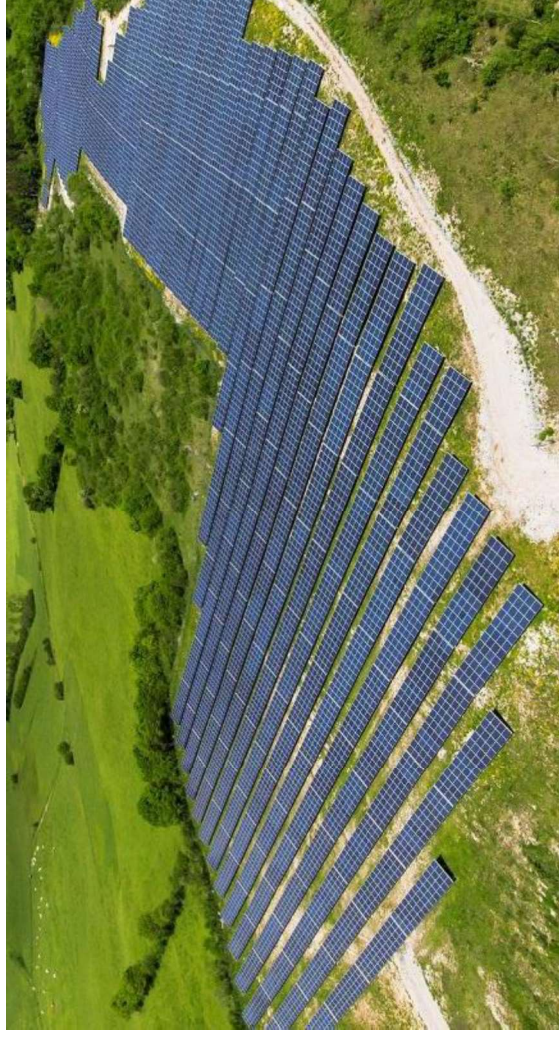
Ferme solaire de Soucia
